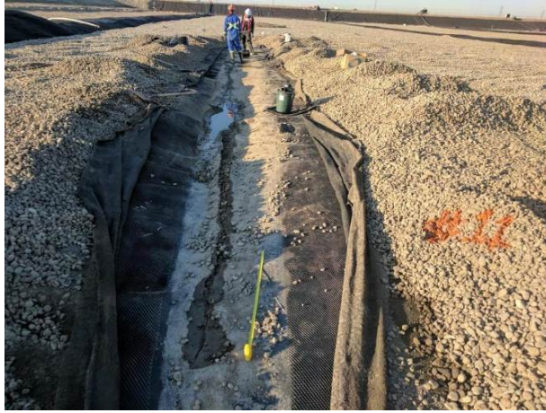
Figure 4. Déchirure de 12 m de long
