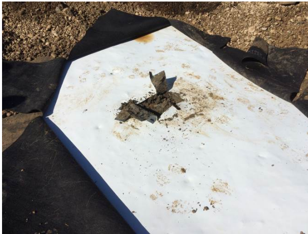
Figure 10. Pièce métallique traversant la géomembrane
