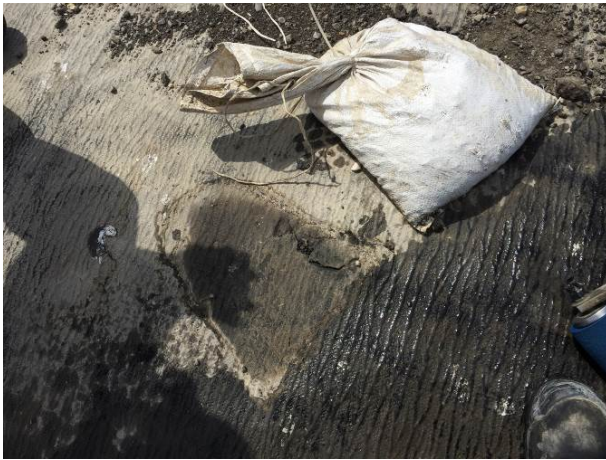
Figure 8. Sac de lest qui cachait une fuite
