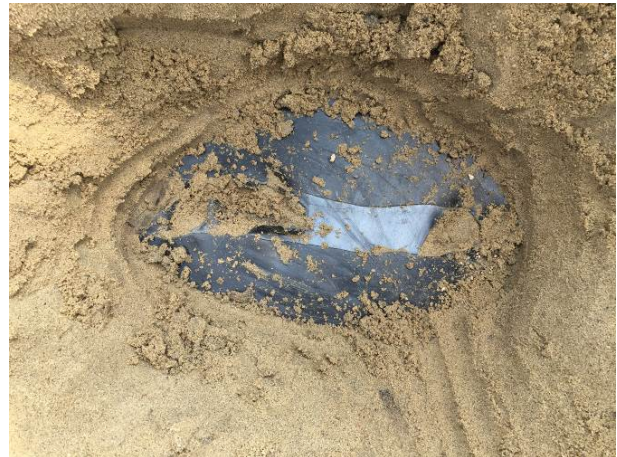
Figure 7. Géomembrane sous vive tension
